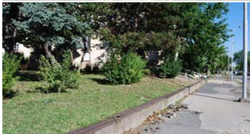
Felújítandó támfal-as ülőfelületek
